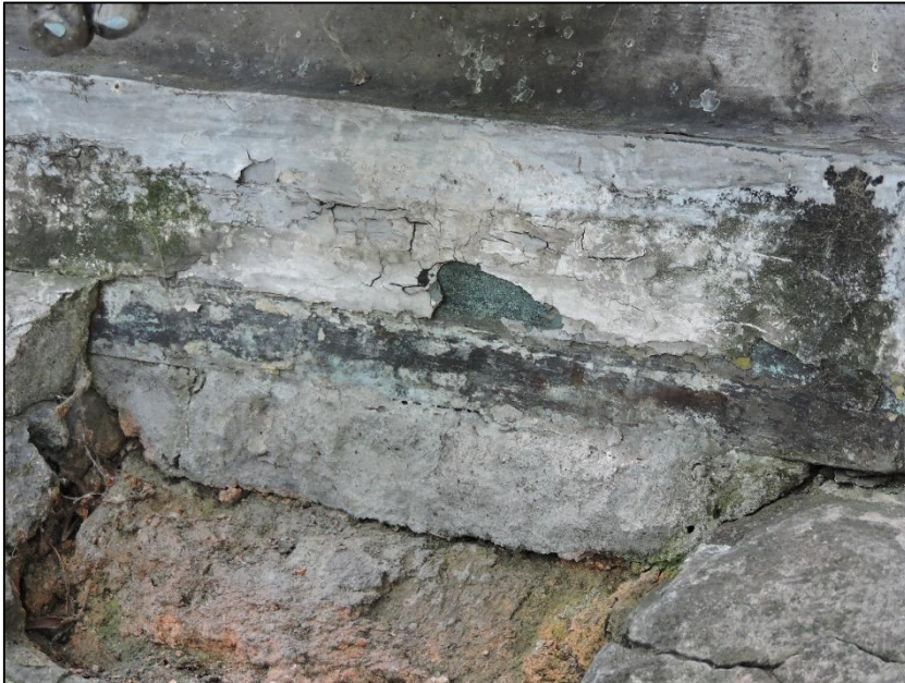
Fot. 20. „Wiktoria rzucają wieniec” – widok fragmentu plinty, na powierzchni złuszczające się warstwy farb, stan zachowania z sierpnia 2015 r.
