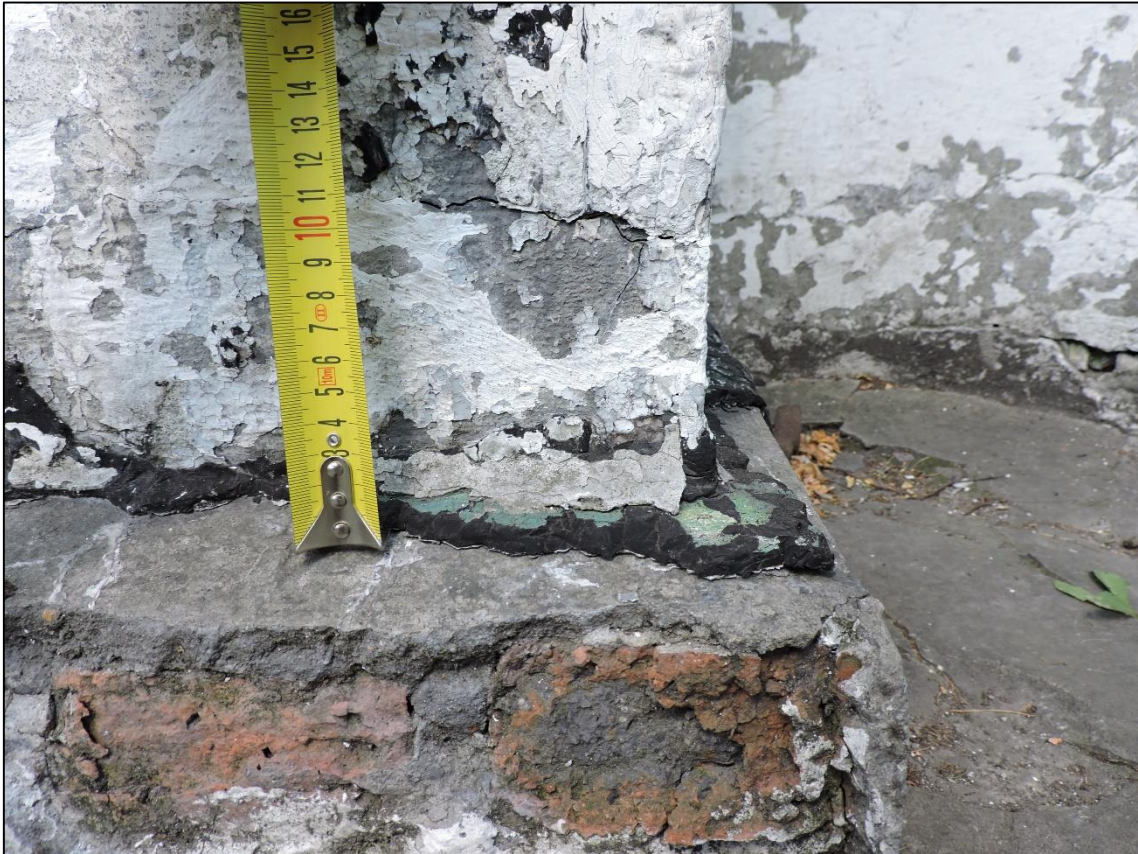
Fot. 22 „Wiktoria rzucają wieniec” – widok grubej warstwy bitumu na cokole postumentu, stan zachowania z sierpnia 2015 r.
